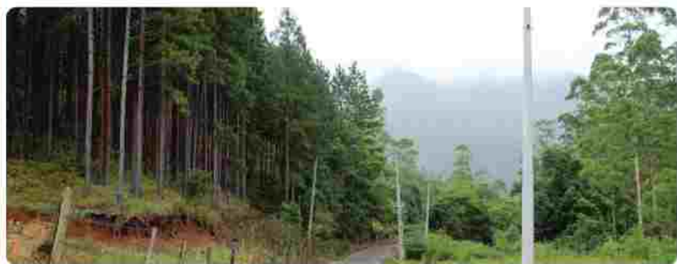
Reforma de rede e alteração para trifásico na localidade de Serra Velha
