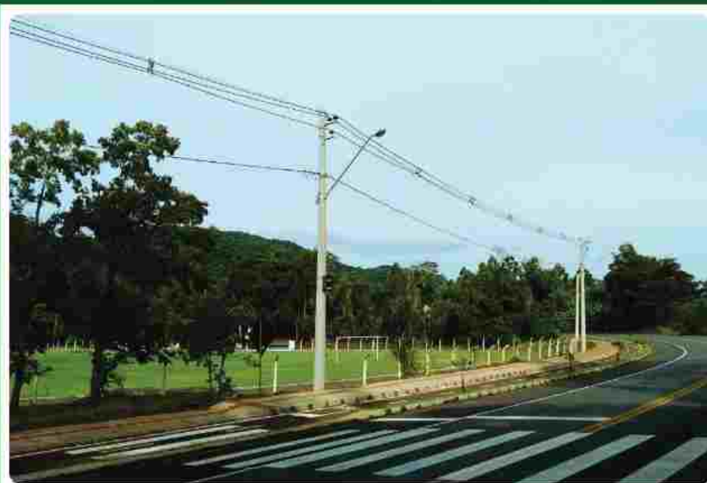
Ampliação de rede com cabos compactos no centro do Morro Grande
