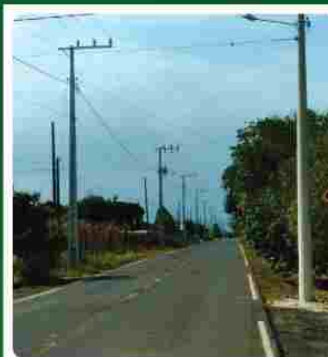
Reforma de rede na localidade de Linha Zenke
