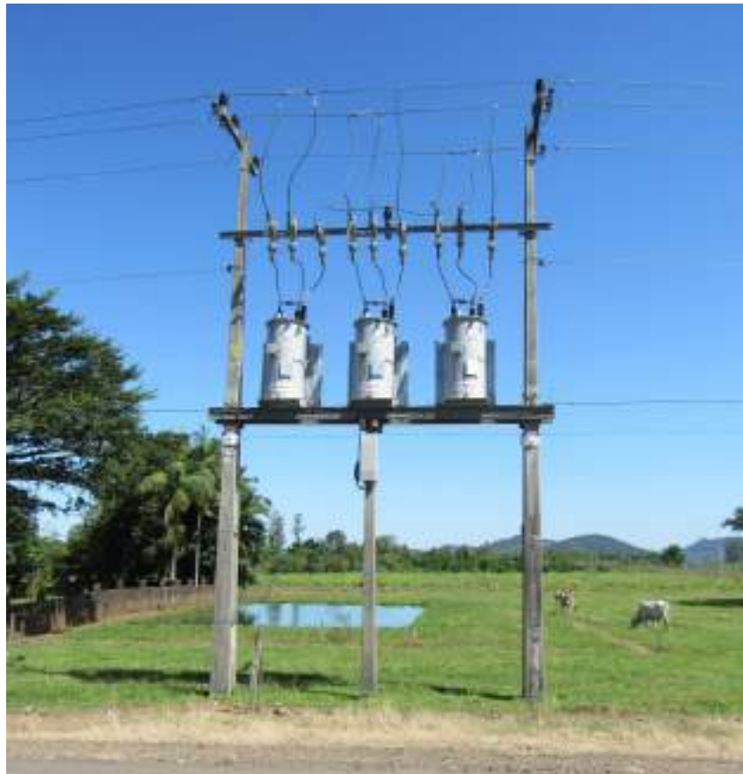
Imagem 2: Banco Regulador de tensão na Vila Progresso; Turvo.
