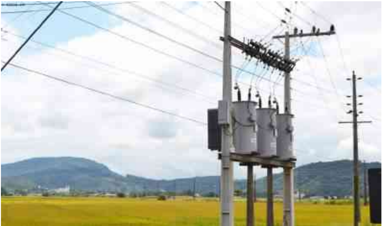
Imagem 9: Banco regulador de tensão; Meleiro.
