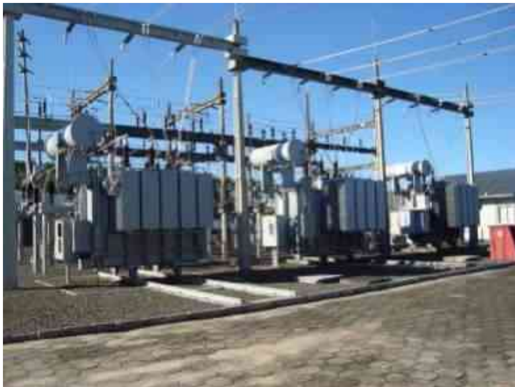
Imagem 10: Panorama dos três transformadores da Subestação 69 Kv – Turvo.
